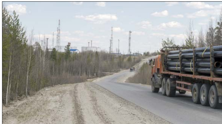
Трубы едут на Аган. В первом цеху поэтапно реализуется программа по замене трубопроводов
